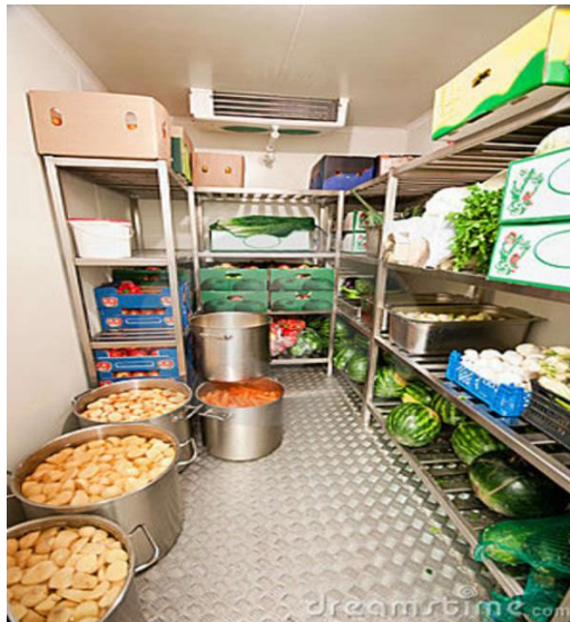
Εικόνα 25: Υγιεινολογικά ορθή αποθήκευση σε ψυκτικό θάλαμο
